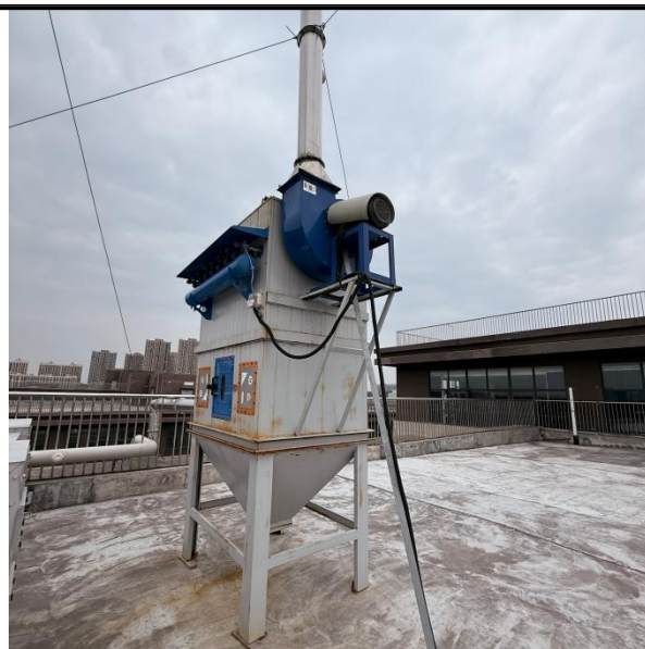
图3-2 32栋楼顶废气处理装置 (TA001)
