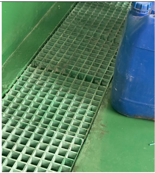
图3-14 危废暂存间截流沟
