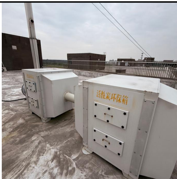
图3-1 32栋楼顶废气处理装置 (TA002)
