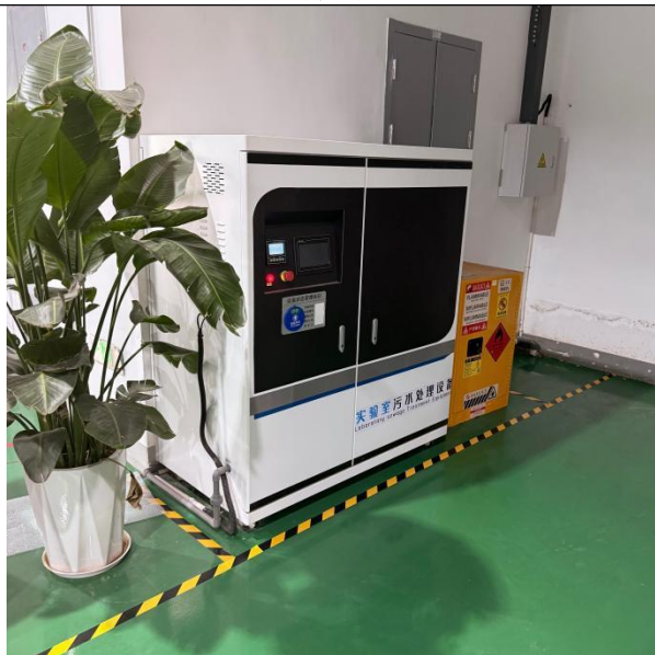
图3-7 废水一体化处理设施
