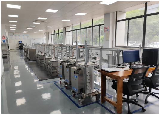
激光光声光谱油中溶解气体在线监测装置 (试验检测区)
