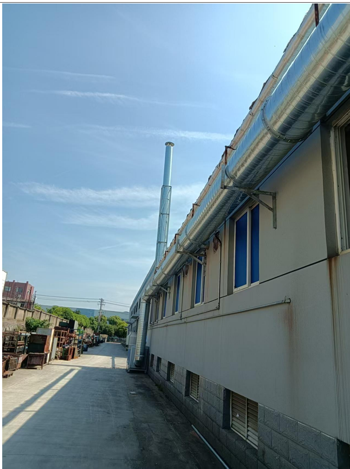
危废库排气筒
