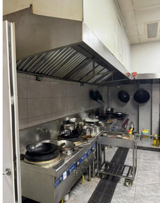
食堂（厨房、顶部集气罩）
