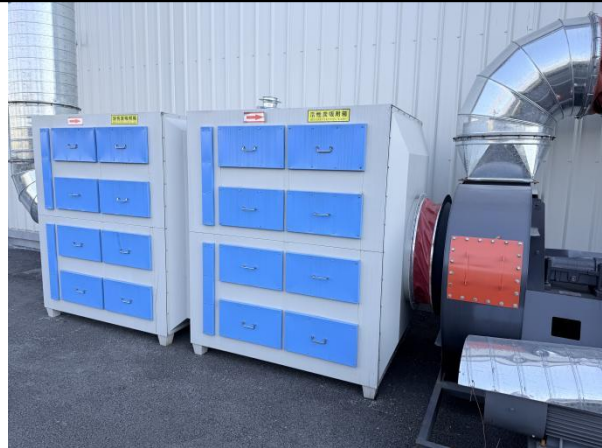
图3-1 3#西侧废气处理装置 (TA001)
