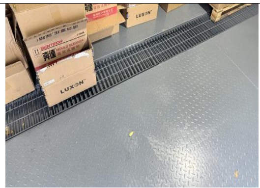
图3-14 危废暂存间截流沟
