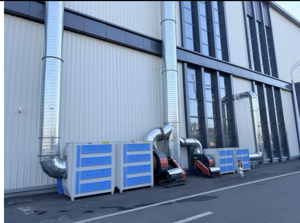
图3-2 3#西侧废气排放装置 (DA001)
