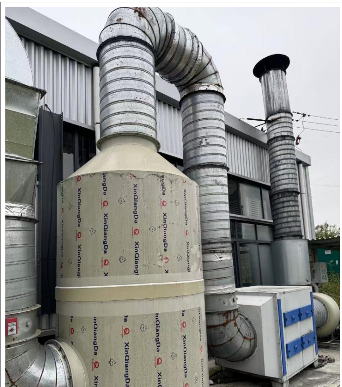
图 2-2 废气处理设施照片
