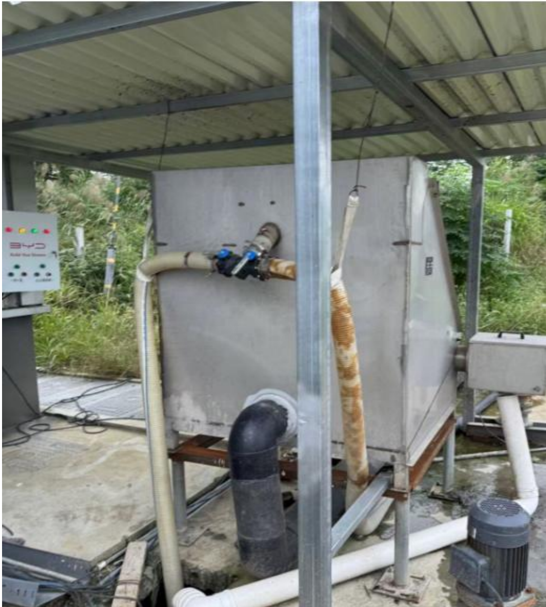
图 2-3 废水处理设施照片
