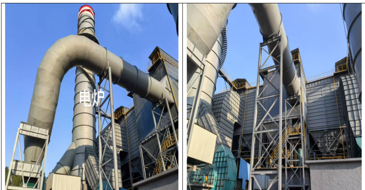
电炉废气处理设施
