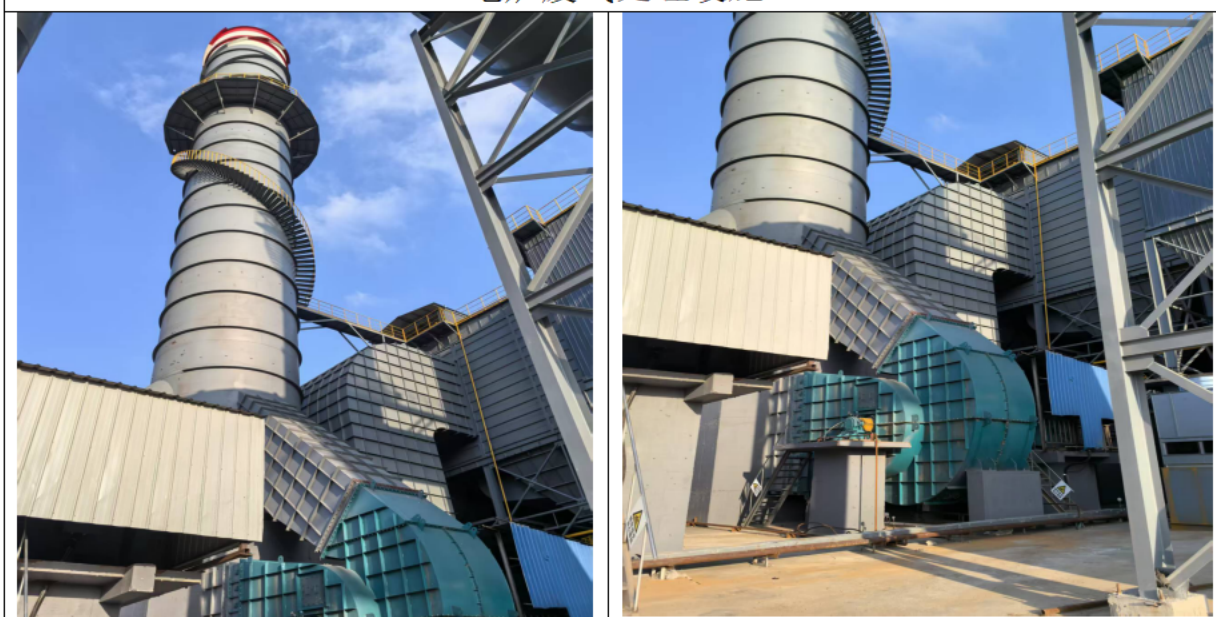
精炼炉废气处理设施
