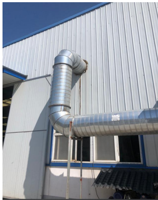
恶臭废气收集管道
