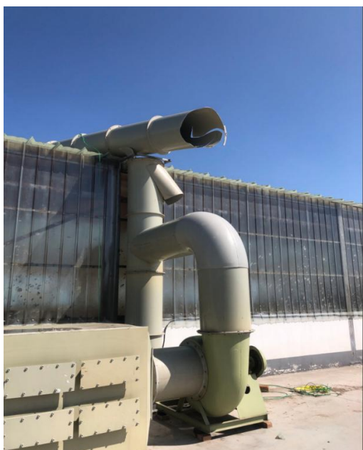
恶臭废气排放口
