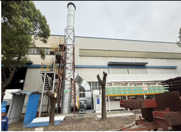
图3-3 南侧废气处理装置(DA002)
