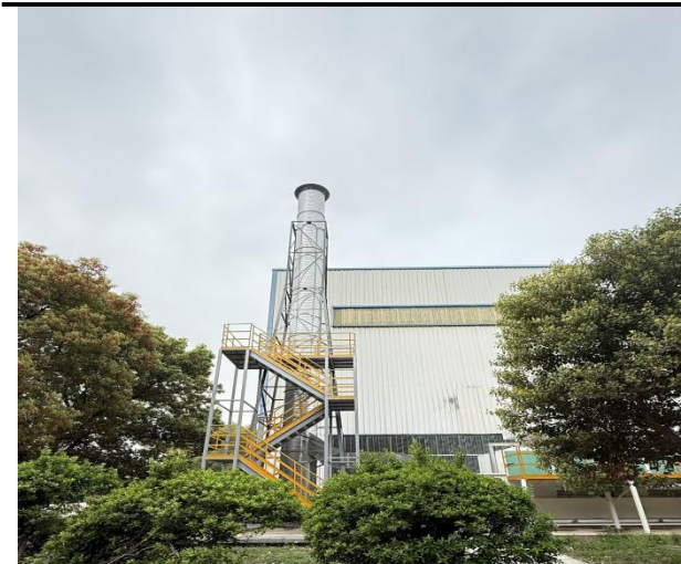
图3-1 东侧废气处理装置（DA003）
