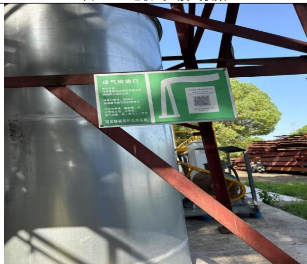
图3-10 DA002(南侧排气管)
