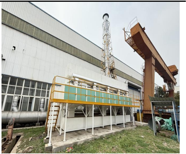
图3-2 北侧废气处理装置(DA001)
