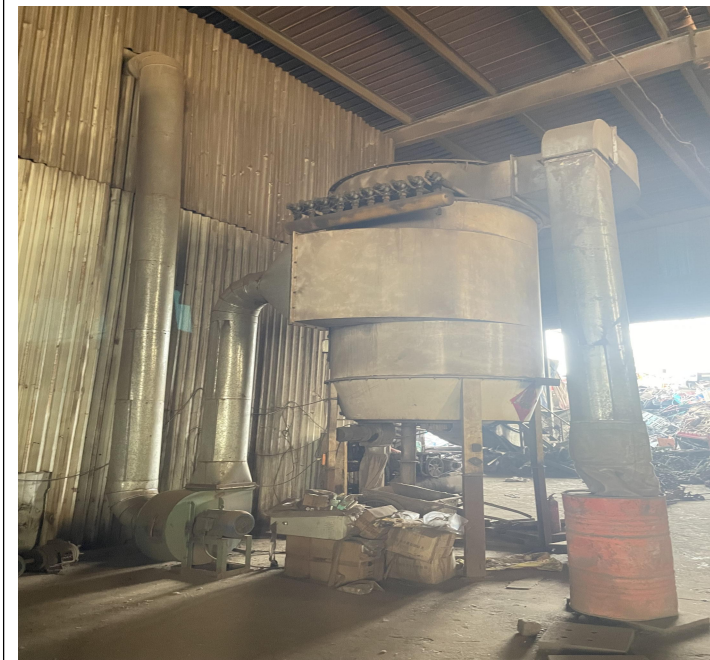
破碎间除尘收集装置
