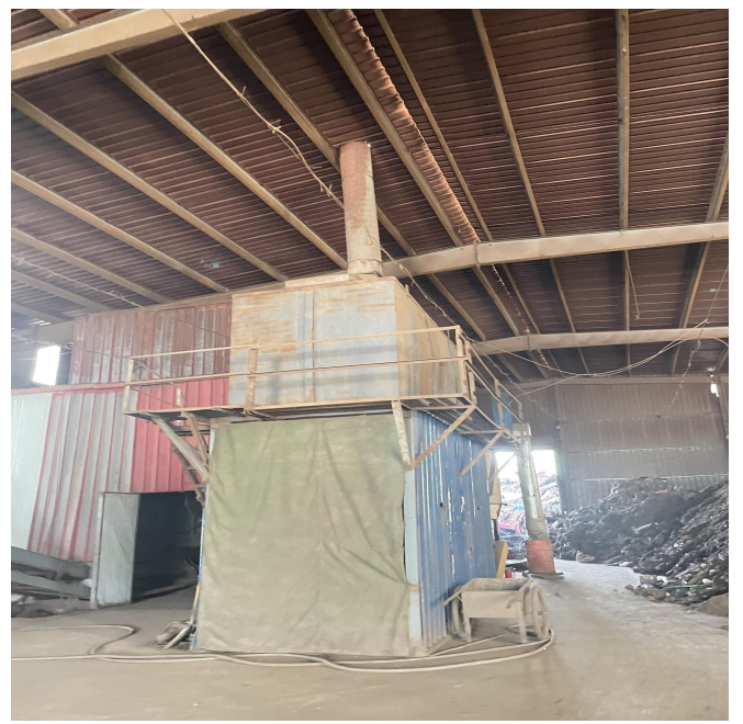
破碎间，破碎机布袋除尘器+15m 高排气筒
