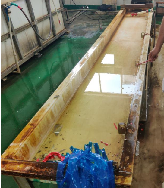
含铬废水处理装置
