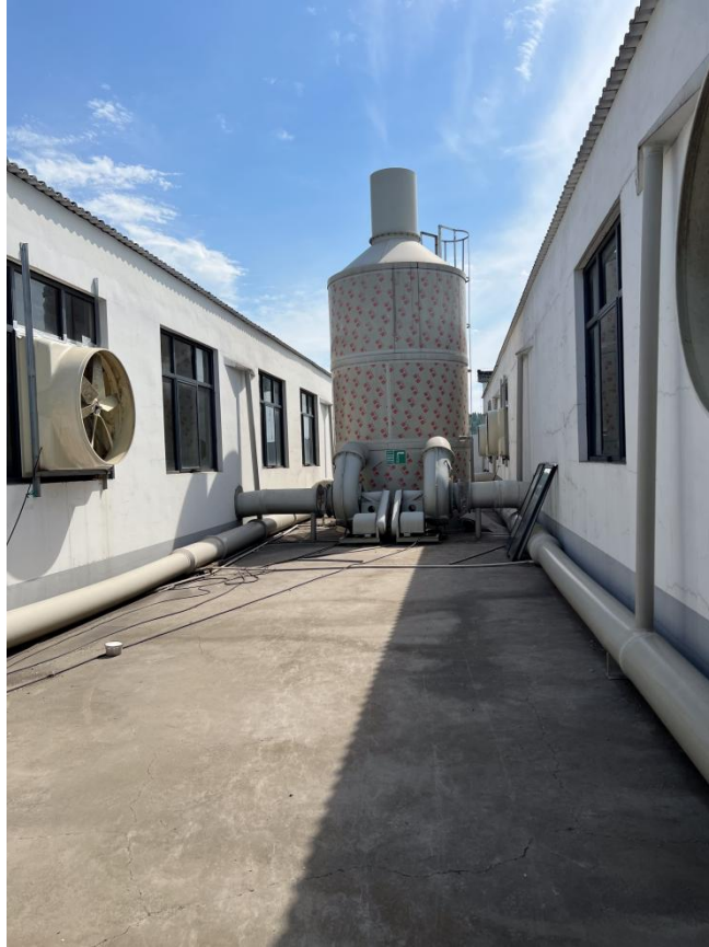
酸雾废气处理设施
