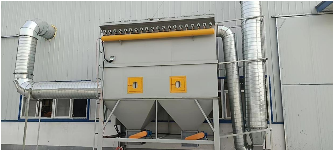
图 3-2 破碎、筛分废气处理设施照片
