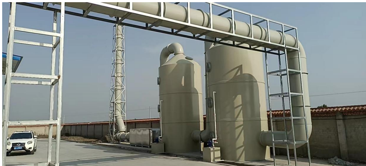
图 3-1 发酵废气处理设施照片
