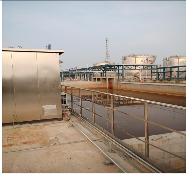
初期雨水收集池
