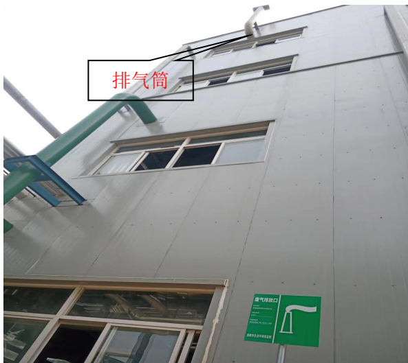
造粒、洗涤工序有机废气排气筒
