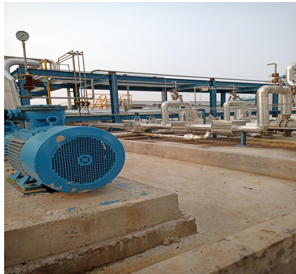
污水提升泵站
