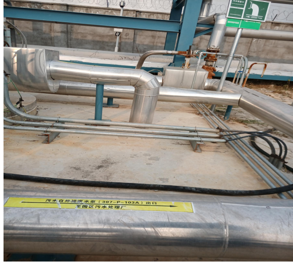
厂区污水排放管线
