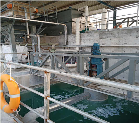
项目污水处理设施
