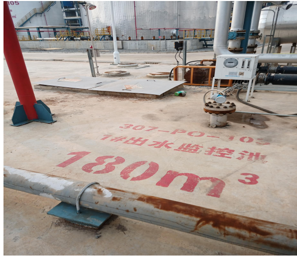
污水外排监控池
