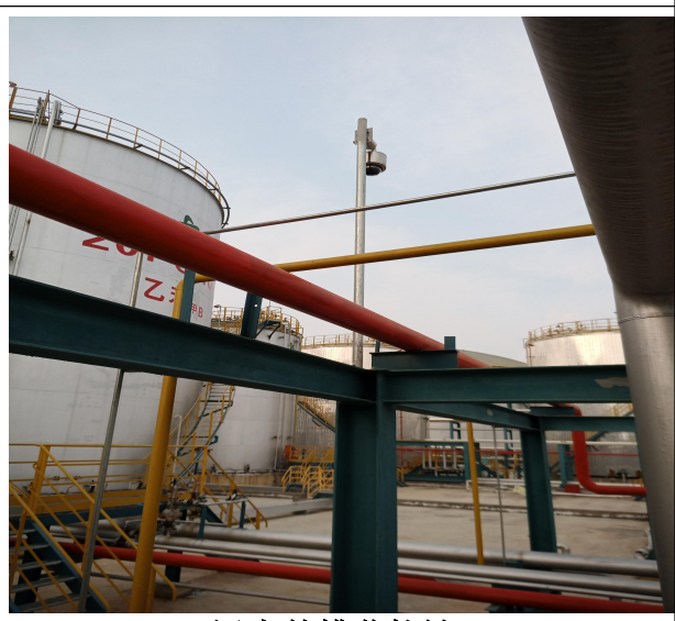
污水外排监控池
