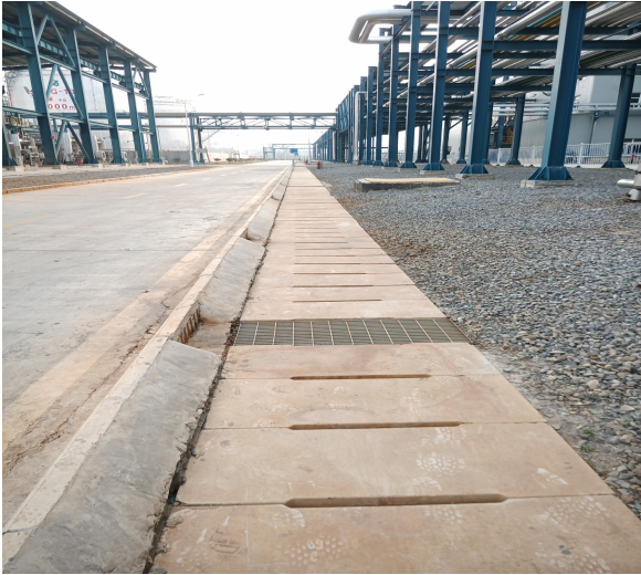
厂区雨水排放管线
