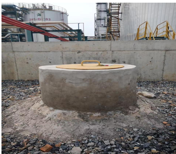
地下水监控井
