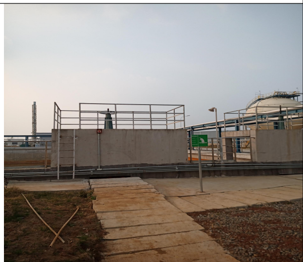
事故水切换阀
