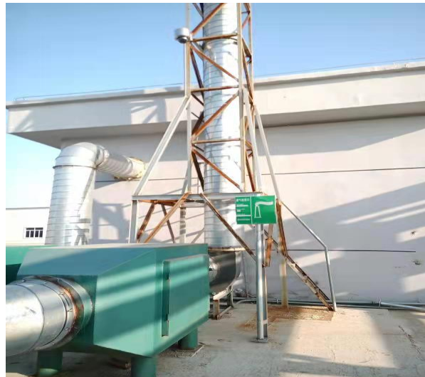
危废库废气处理设施及排气筒
