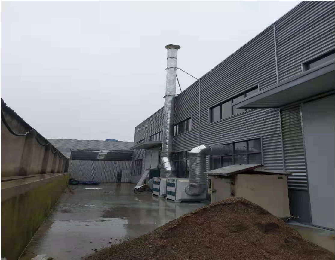
喷漆废气处理设施及排气筒
