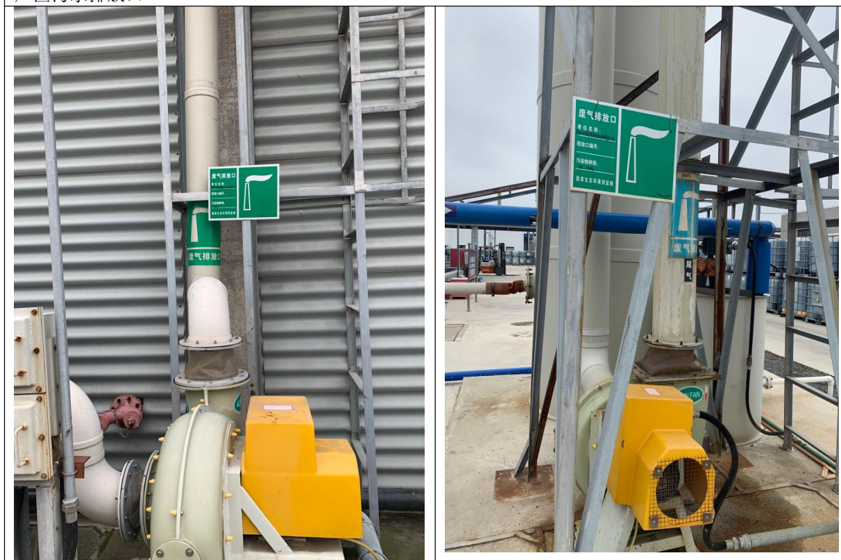
厂区废气排放口（二级活性炭装置、储罐区水吸收装置）
