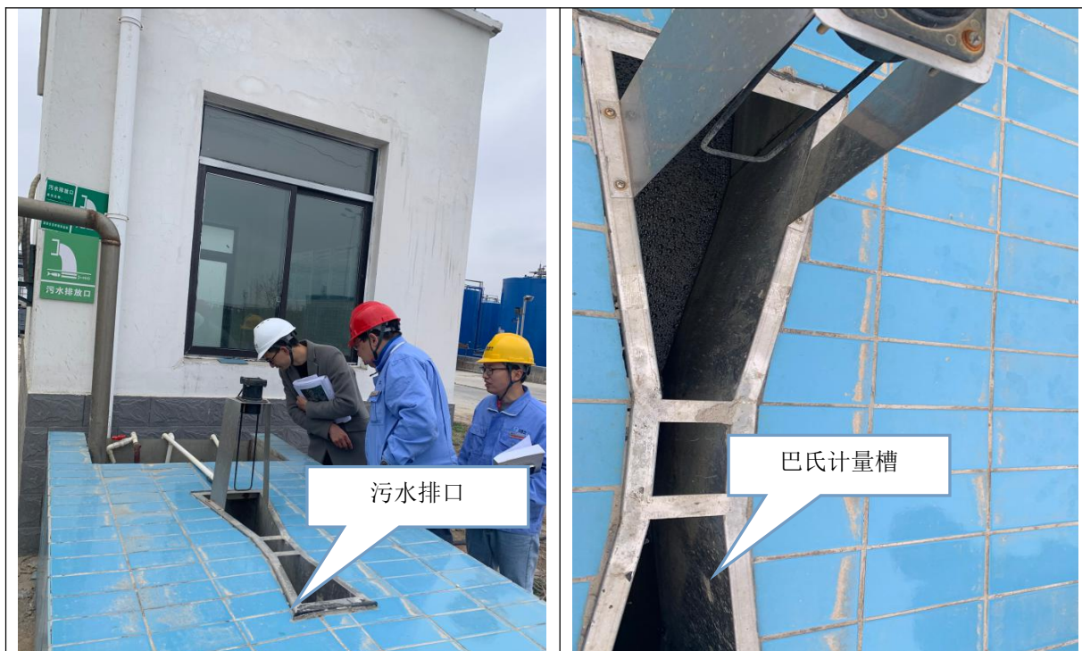
厂区污水排放口
