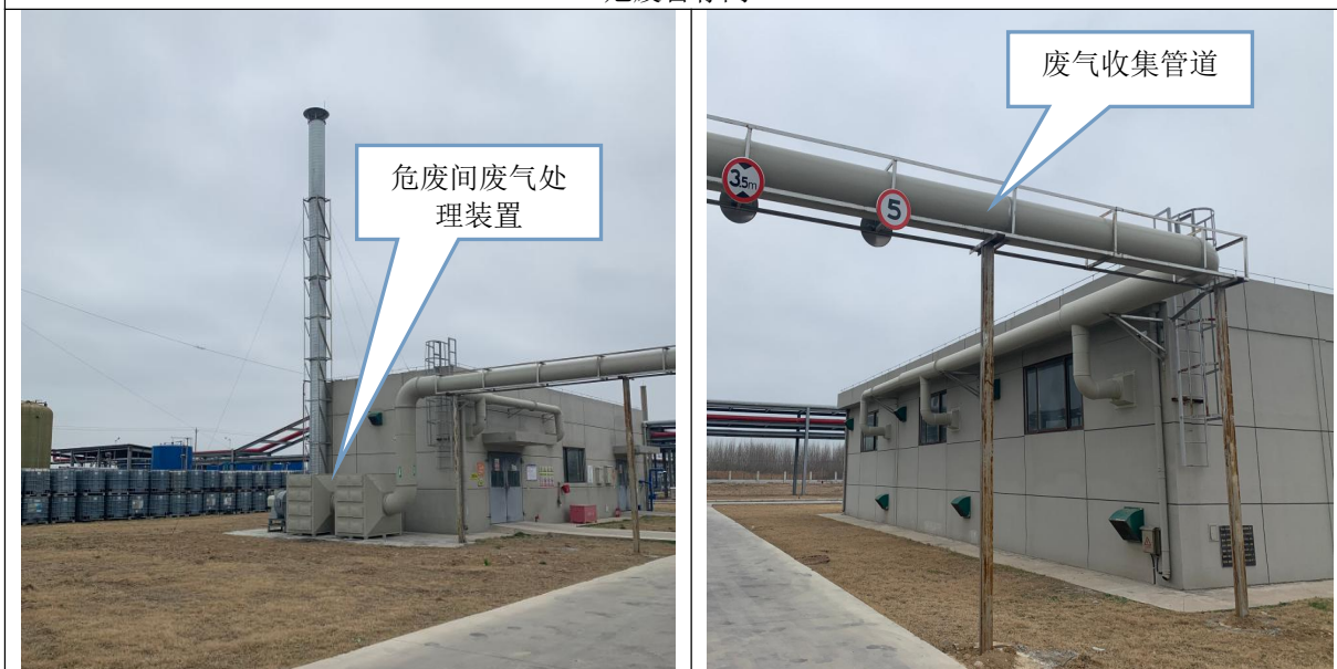
危废间废气收集处理装置
