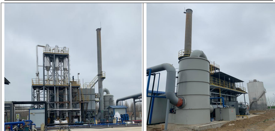
RTO 焚烧装置
