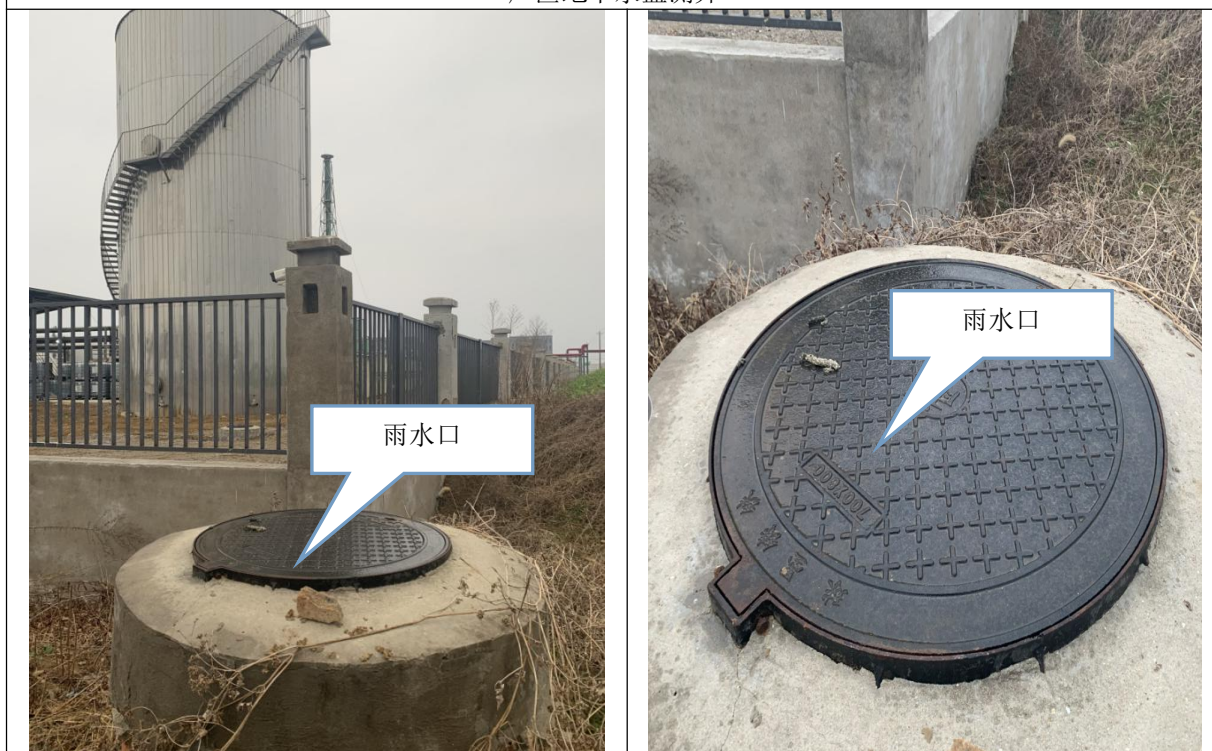
厂区雨水排放口
