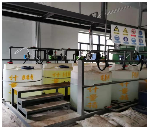
生产废水处理加药装置
