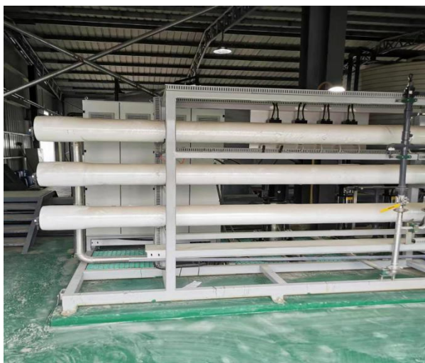
渗滤液超滤系统
