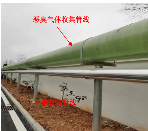
甲烷和恶臭气体收集管线
