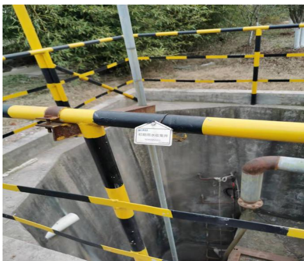
初期雨水集水井
