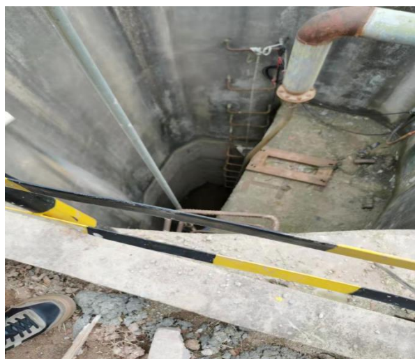
雨水排口应急切断阀
