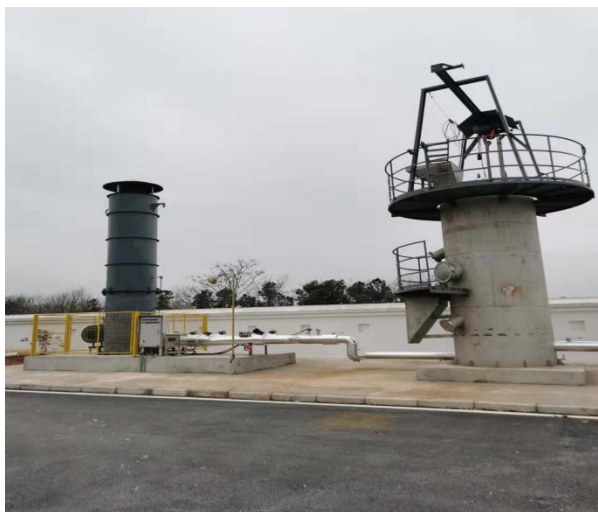
渗滤液处理站火炬系统
