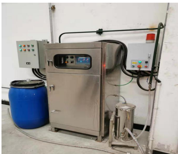
植物喷淋除臭系统
