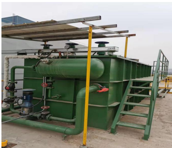
生产废水处理装置
