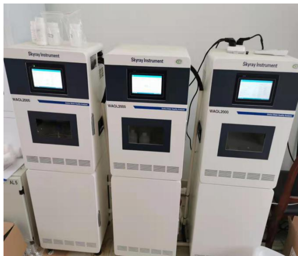
渗滤液处理站在线监测系统
