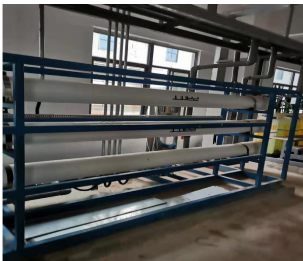
生产废水处理反渗透装置
