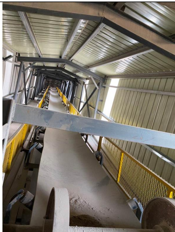
新增水泥粉磨调配站皮带机全封闭
