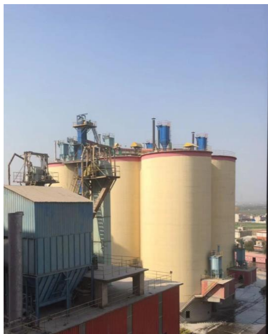
现有水泥仓仓顶除尘器
