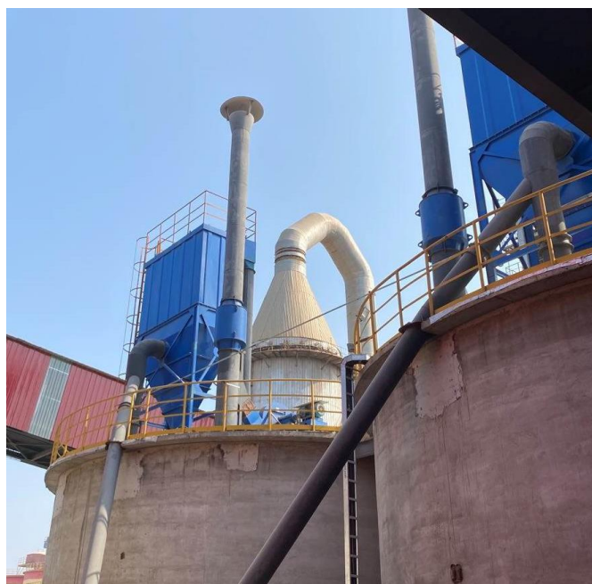
粉煤灰仓仓顶除尘器
