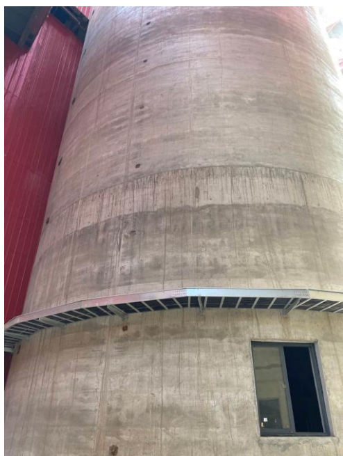
技改新增粉煤灰仓
