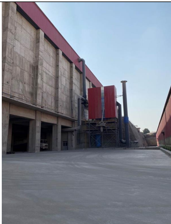
新增混合材堆棚袋式除尘器
