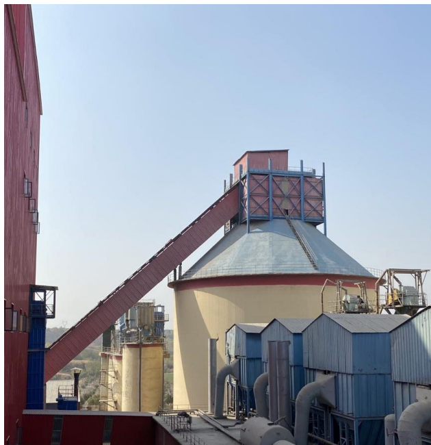
现有熟料仓仓顶除尘器
