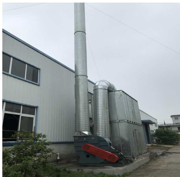
中央除尘系统+15m高排气筒
