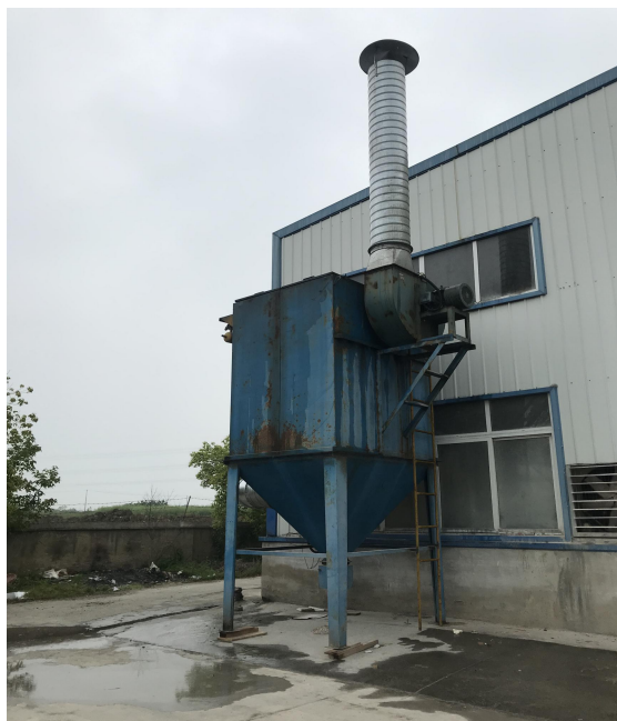
打磨房布袋除尘器
