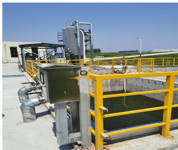
废水处理设施
