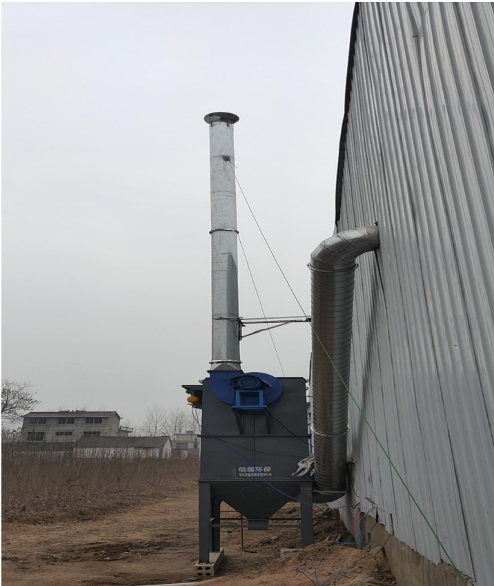
制粒机、成品库脉冲除尘器+15m 搞排气筒
