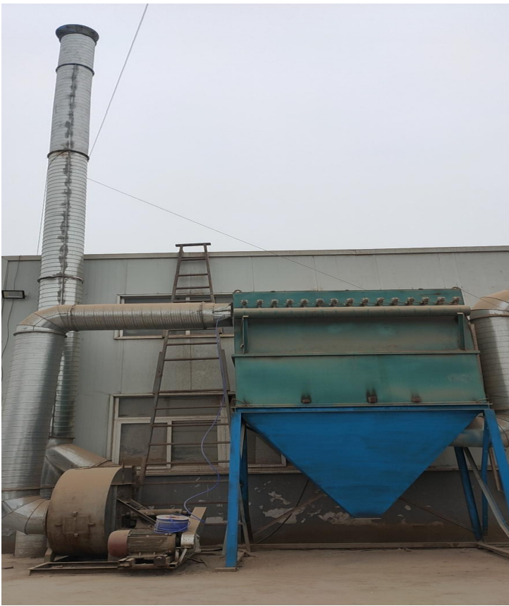
破碎、粉碎、筛分脉冲除尘器+15m 搞排气筒
