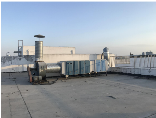
UV 光氧+活性炭吸附装置”+20m 高排气筒” (2#)
