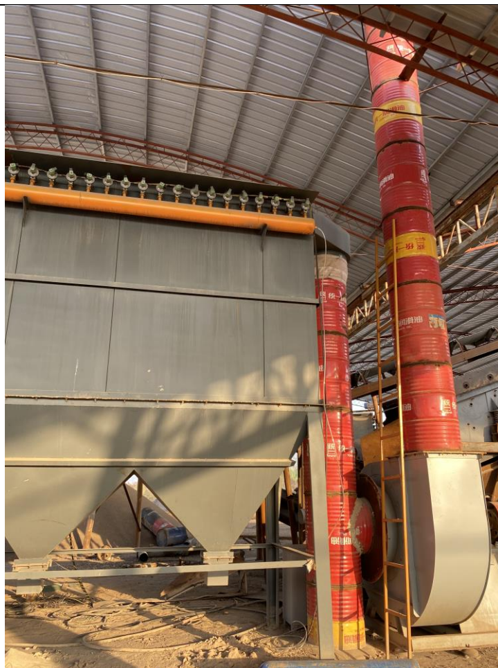
图 3-4 破碎、筛分粉尘处理装置
